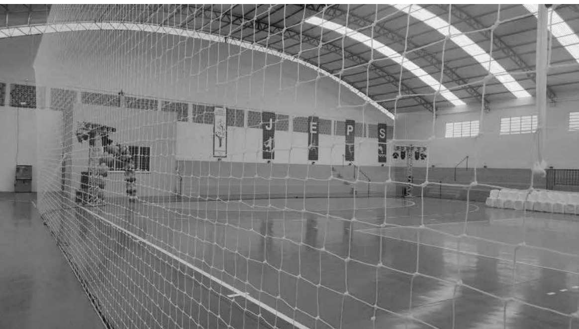
Ginásio de Esportes que ficou fechado por dois anos agora esta totalmente reformado e disponível para população
