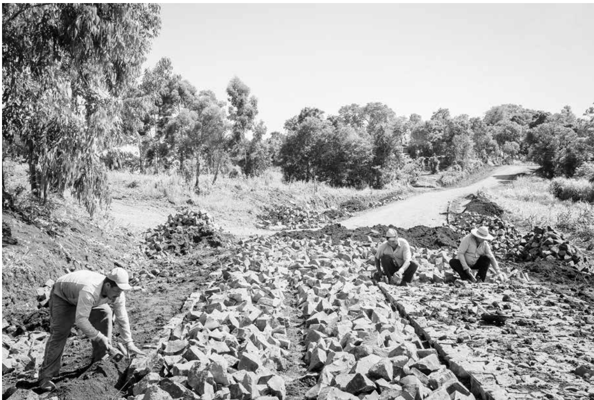
Pavimentação da rodovia municipal João Antonio Wolff, no trecho entre os distritos de Guarai e Rio da Prata, em Nova Laranjeiras, no Centro Sul do Estado
